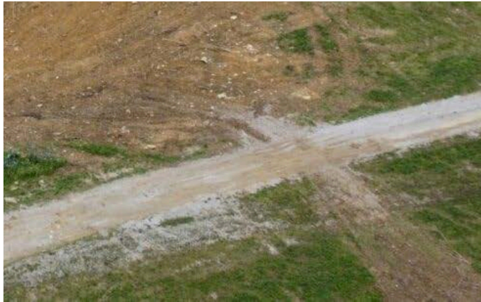
Entrada de construcción no instalada correctamente
